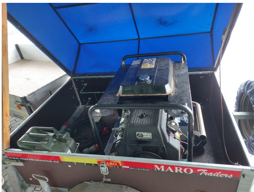
Obrázek 14 Elektrocentrála v mobilní jednotce (vlastní fotografie, 2024)
