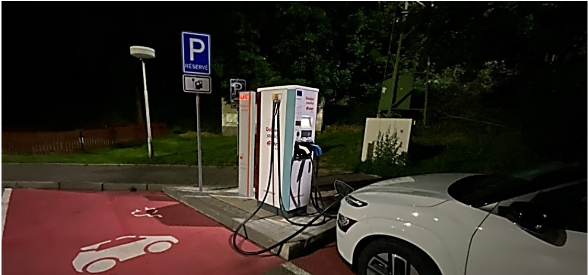
Obrázek 12 Dobíjecí stanice E.ON (Kavalčík, ©2021)
