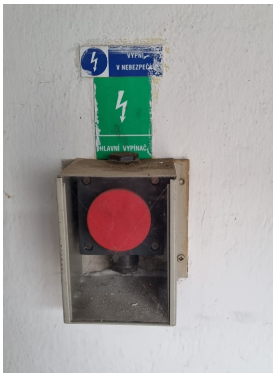
Obr. 16 – Tlačítko nouzového vypnutí (Vlastní).
