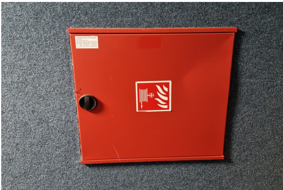
Obr. 14 – Hydrantová skříň D25 (Vlastní).
