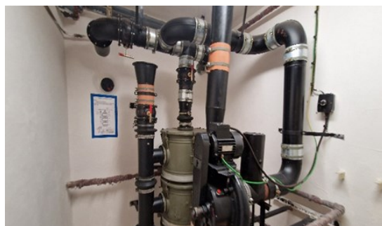
Obrázek 11 - Strojovna s filtračním a ventilačním zařízením. (Vlastní, 2023)
