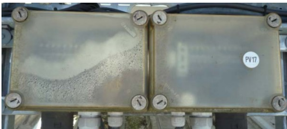
Obrázok 20 - Vodotesné IP65 rozvodné boxy po 15 rokoch prevádzky [44]
