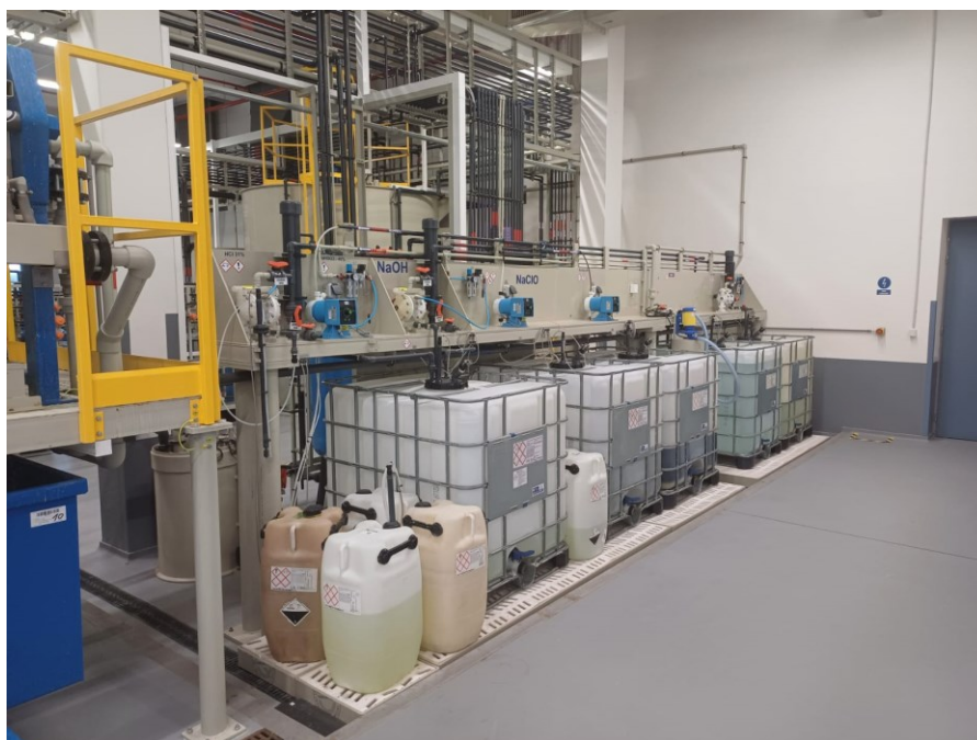
Obrázek 5 Neutralizační stanice (zdroj: Vlastní, 2024)
