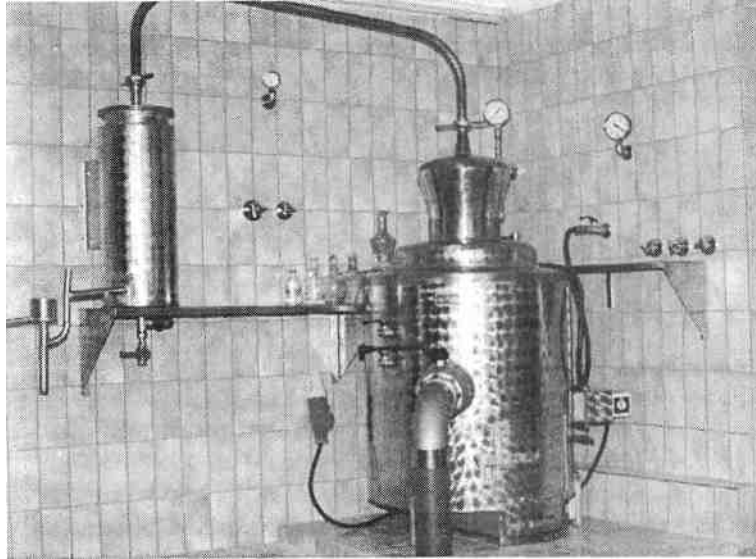
Obr.č.9: Kotel s elektrickým ohřevem
