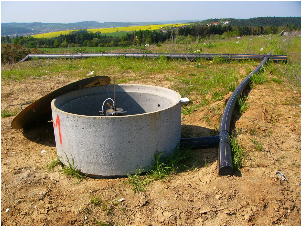
Obr. 8 Systém odplynění skládky Suchý důl - III etapa (2009)
