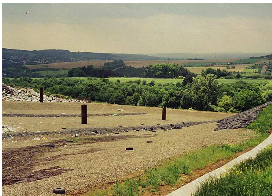
Obr. 3 Systém odplynění skládky Suchý důl - II etapa
